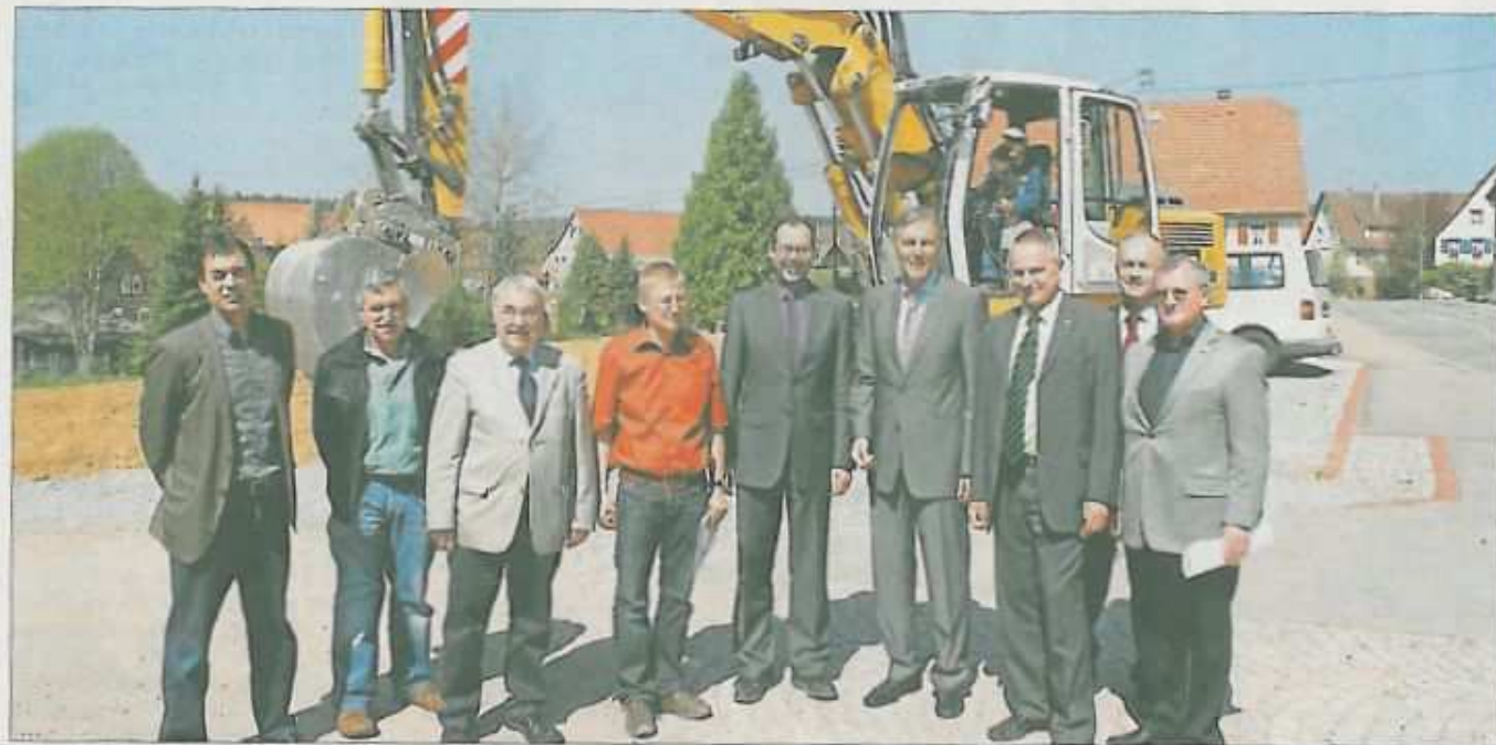
Gestern begannen die Arbeiten in der Schönbronner Ortsdurchfahrt. Den Startschuss gaben (von links) Planer Paul Gauss, Bauleiter Martin Bürkle (beide Büro Gauss und Lörcher), Rainer Prewo, Bauleiter Norbert Albus (Firma Stumpp), Bürgermeister Ulrich Bünger, Landrat Helmut Riegger, Thomas Blenke, Albrecht Keller (KE) und Ortsvorsteher Herbert Schucker. Foto: Geideck
