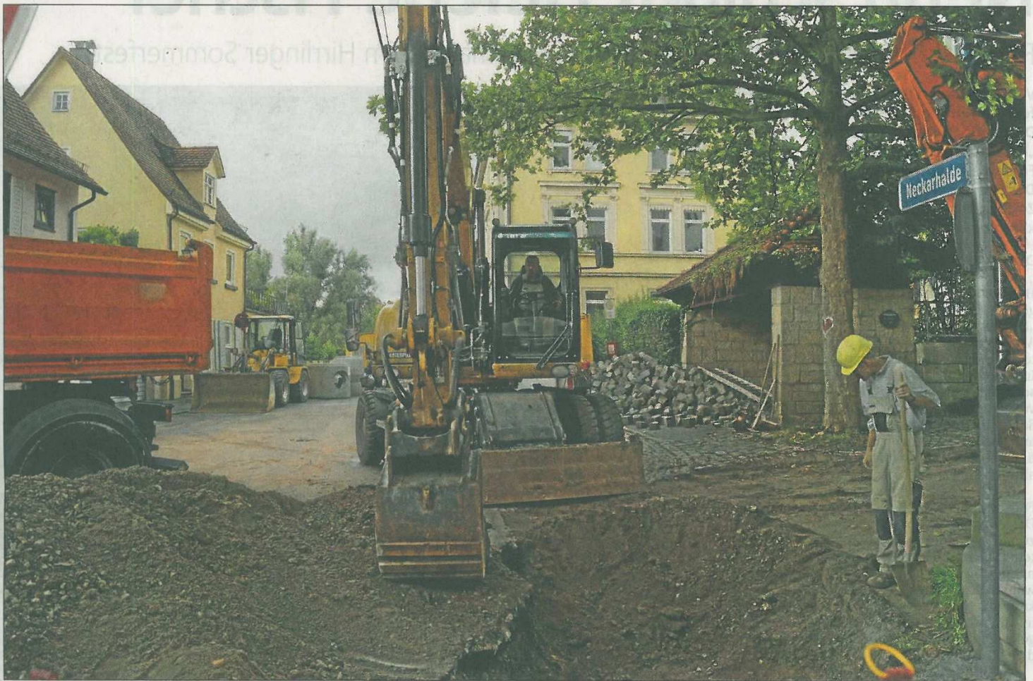
Vor Überraschungen ist man bei Erdarbeiten nie sicher – hier am Beginn der Neckarhalde vor dem ehemaligen Finanzamt.
